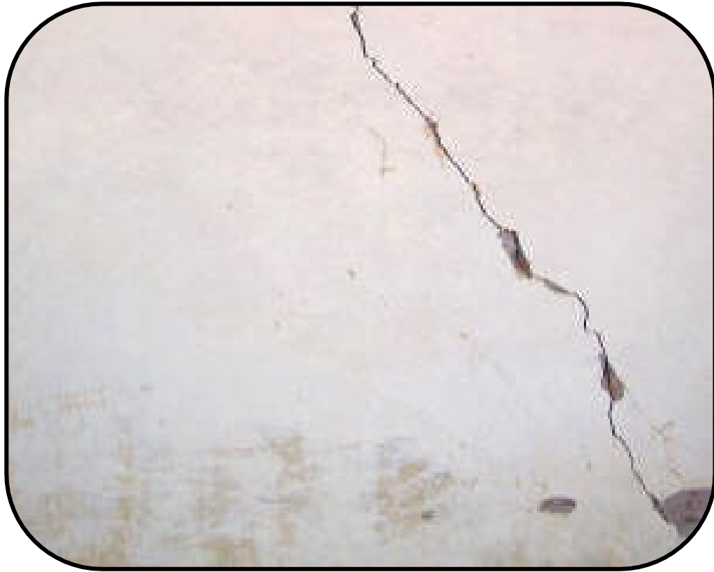
شکل ۲) ترک عمیق روی دیوار
